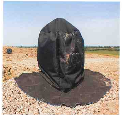
Torrino di scarico biogas con cappuccio antiodore
